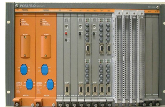
Power Modules CPU Module Comm. Modules I/O Modules
